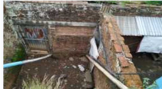
Gambar 2 : Kondisi MCK Sebelum Adanya Revitalisasi
