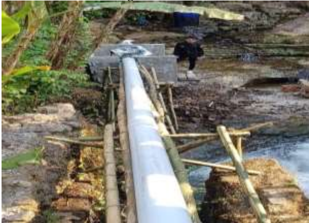
Gambar 2. Pipa Pesat PLTMH Lembah Kemuning Kab. Malang
