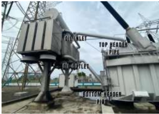
Gambar 1. Interbus Transformer beserta pipa-pipa utama
