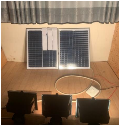
Gambar 7 Dua Modul Photovoltaic Dan Tiga Lampu Halogen Dengan Sistem Shading
