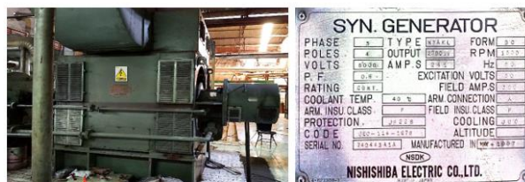
Gambar 3 generator shinko dan name plate
