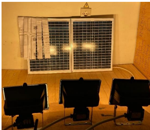
Gambar 7. Dua Modul Photovoltaic Dan Tiga Lampu Halogen Dengan Sistem Shading
