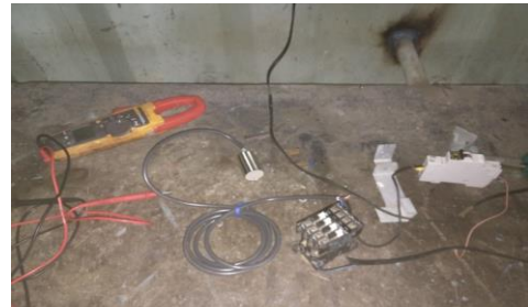
Gambar 4. 1 Pengujian Sensor Proximity Sumber :Pemeliharaan Listrik dan Instrument Crusher
