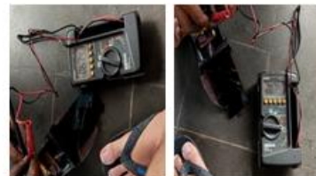
Gambar 3.2 Pengujian Output pada Generator
