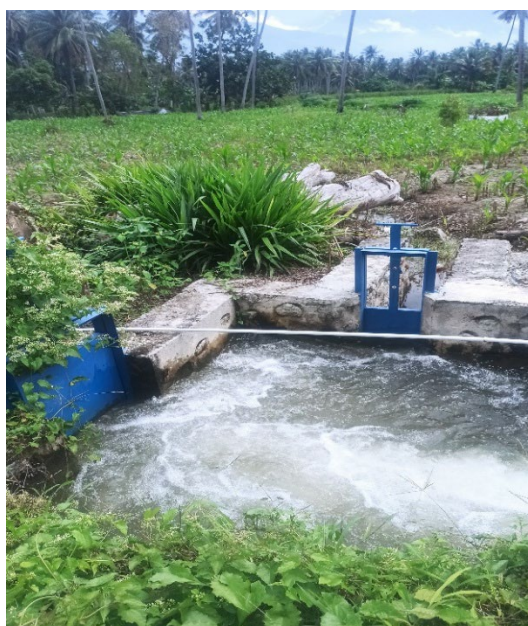
Gambar 7. Pintu Air Saluran Ramba Sumber: Dokumentasi Pribadi,2025
