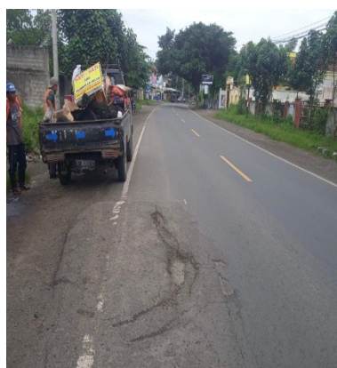
Gambar 4. Sungkur STA 4+000 Sumber : Dokumentasi Pribadi (2024)
